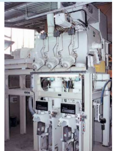
Automatisierte Mischanlage für Baukleber
